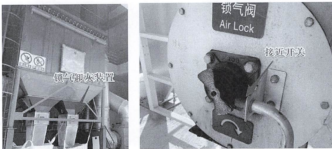
图 21 锁气卸灰故障监测示例
